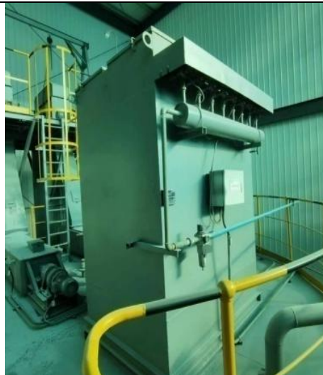
飞灰仓顶布袋除尘器
