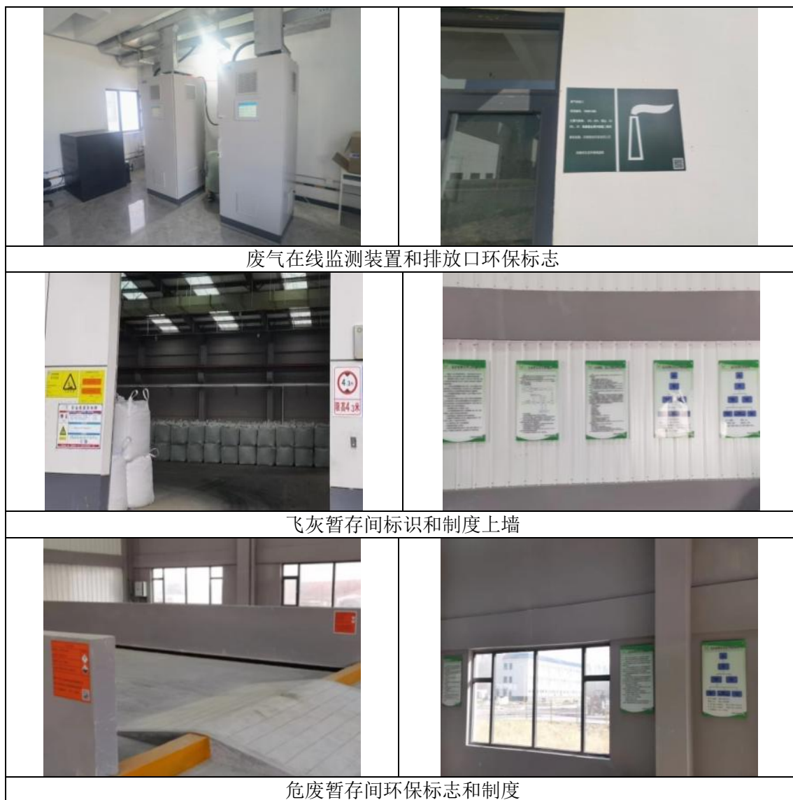
图 5-9 本项目环保标志设置情况及在线监测装置安装情况
