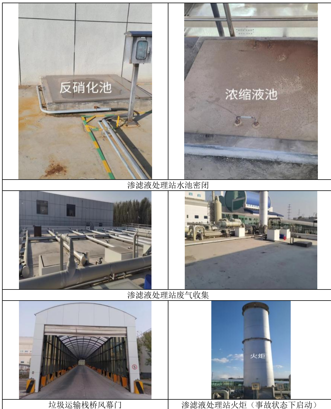
图 5-1 本项目废气治理设施实际建设情况
