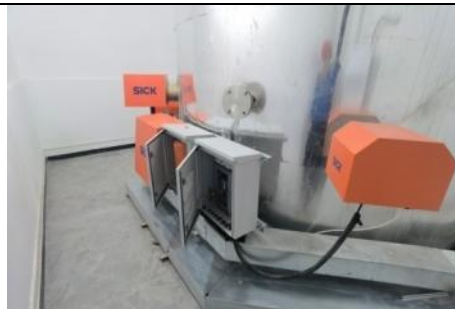
5#炉废气监测采样平台
