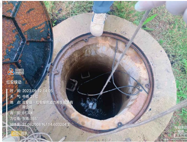
☆雨水采样点 - 雨水排放口
