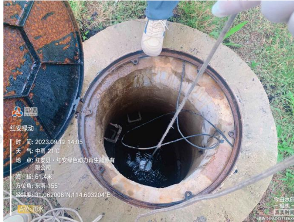
☆雨水采样点 - 雨水排放口
