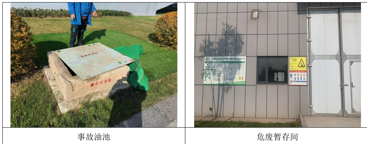
图 8-3 事故油池及暂存设施情况照片
