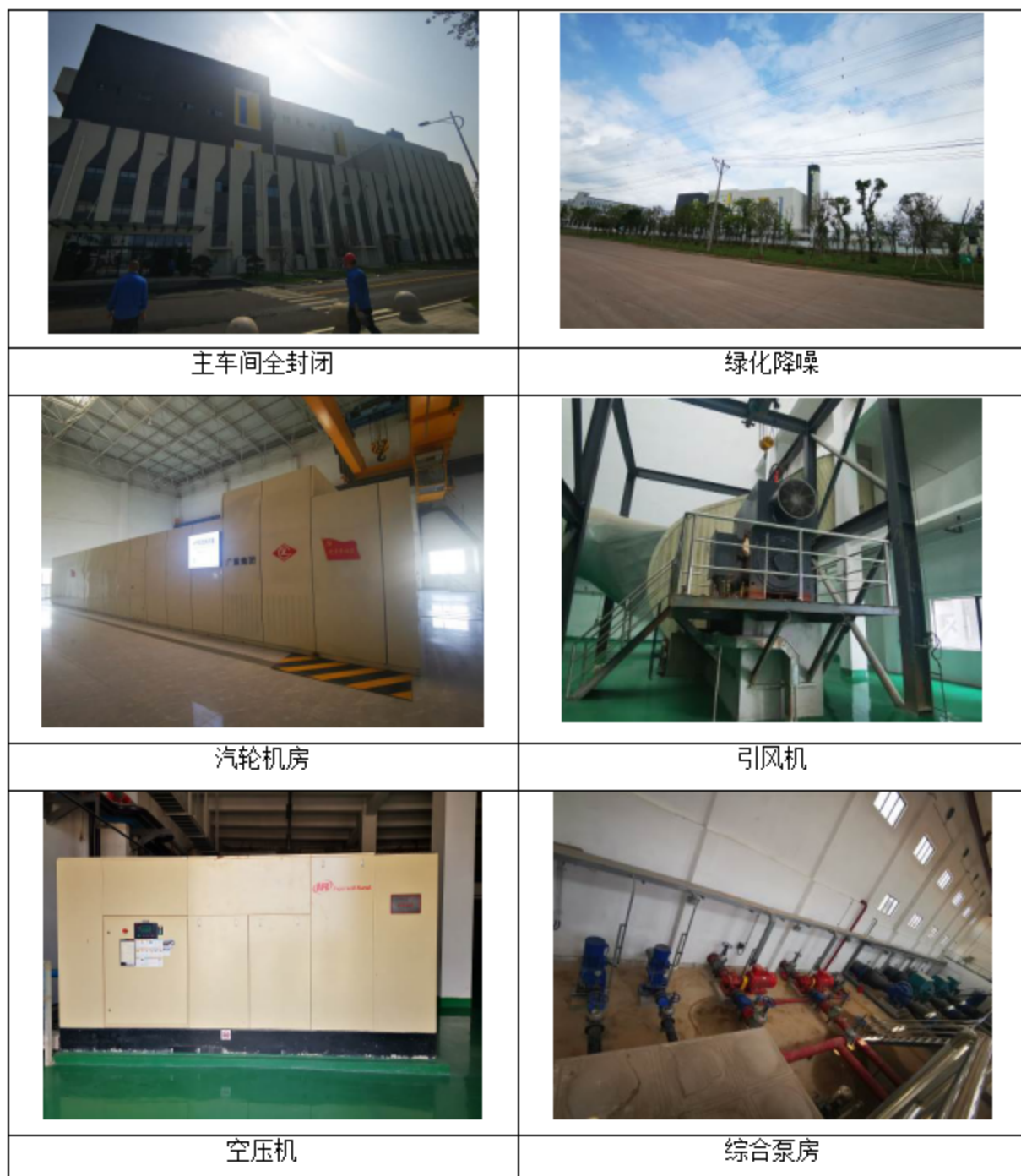
图4.1-2 噪声设备降噪措施现场照片
