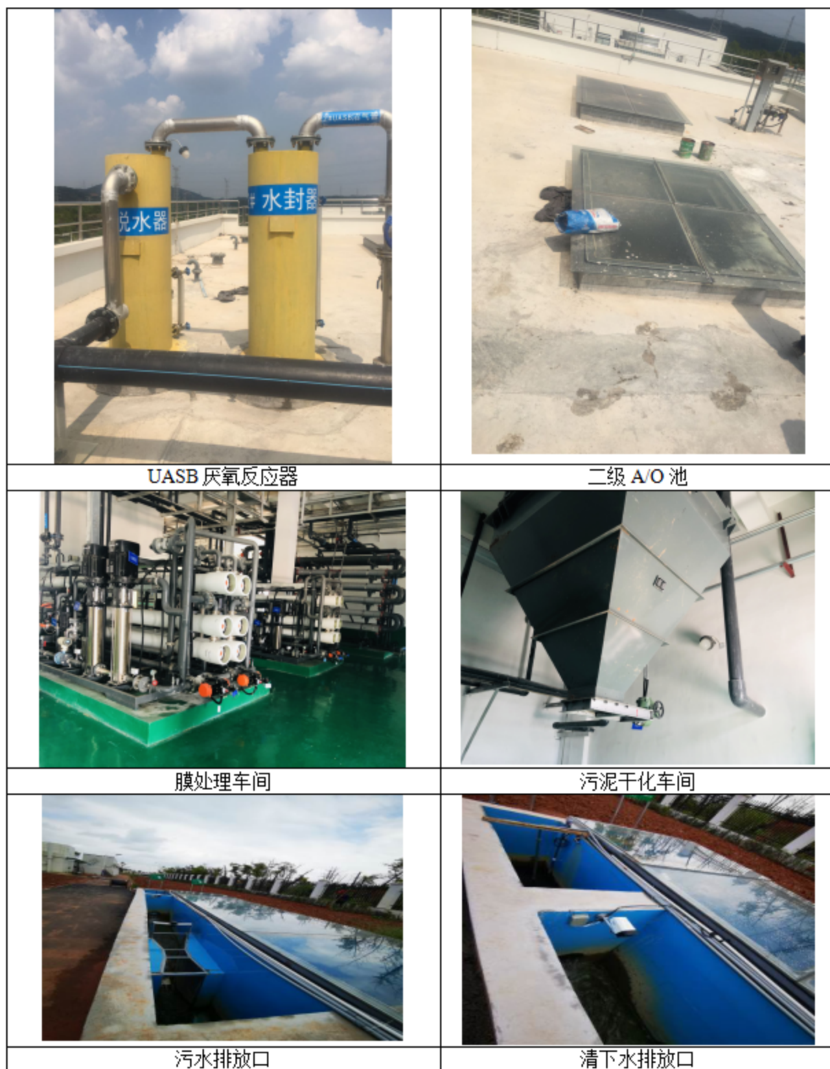
图4.1-1 项目废水治理措施现场照片
