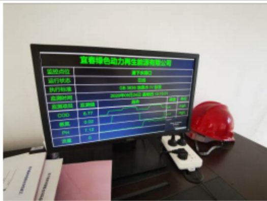
清下水排放口在线监测装置
