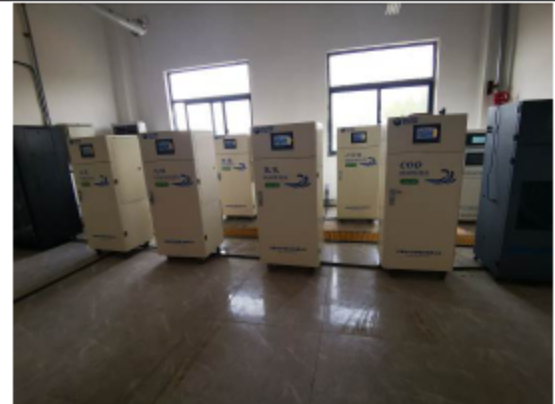
渗滤液处理站出口在线监测装置
