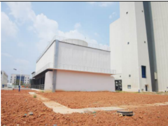
循环冷却系统
