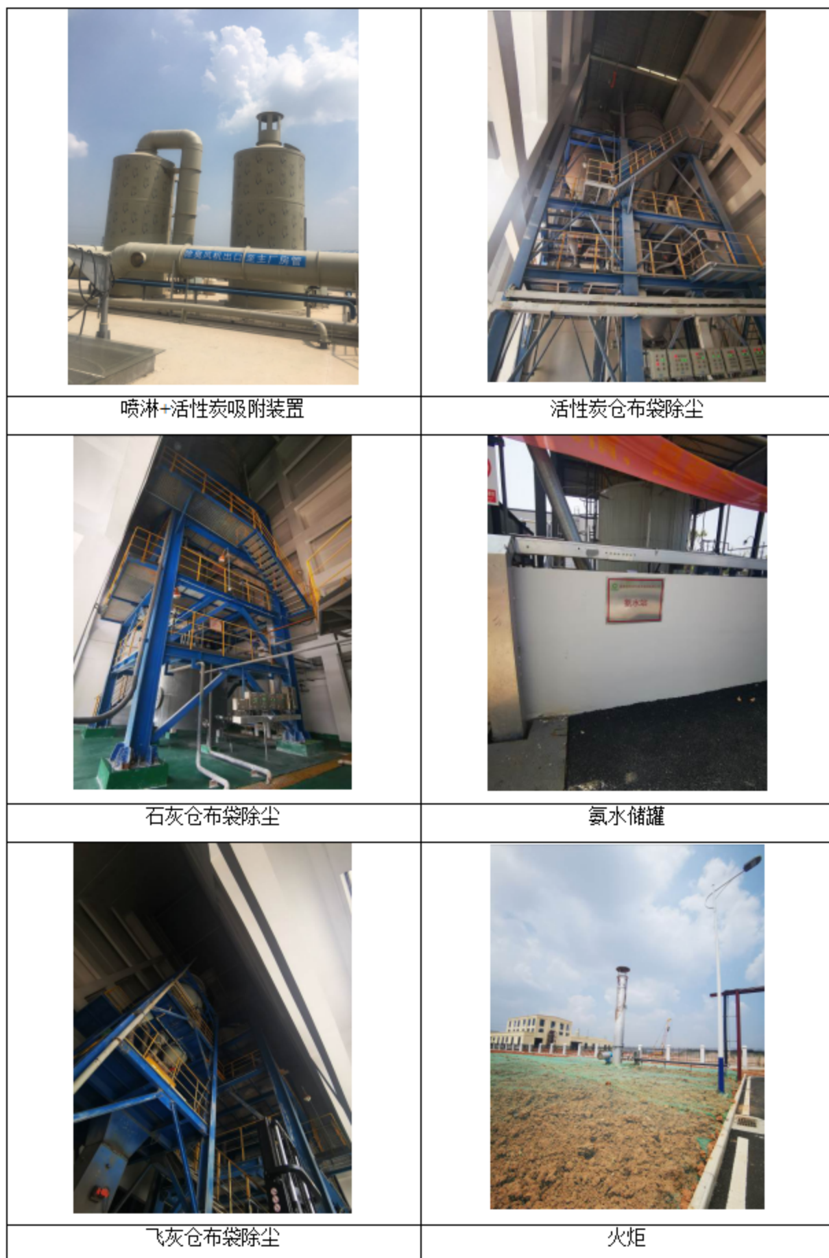
图 4.1-2 项目废气治理措施现场照片
