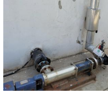
事故池提升泵
