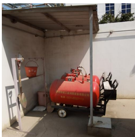
灭火器 消防桶、铁锹
