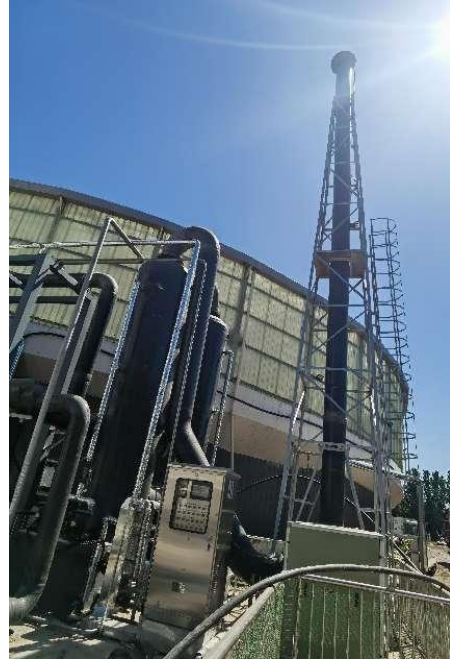
应急废气净化系统
