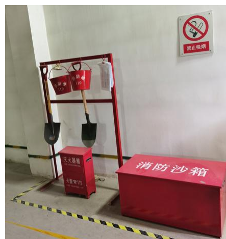
消防沙箱 消防桶 铁锹 灭火器
