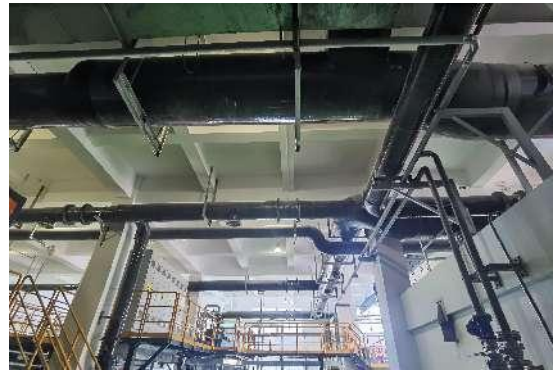
配套除臭系统（管道和风机）
