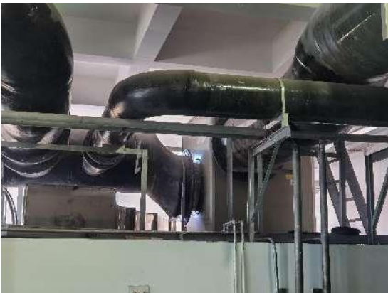
配套除臭系统（管道和风机）
