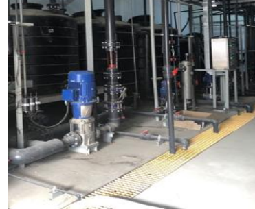
膜处理车间地面收集槽
