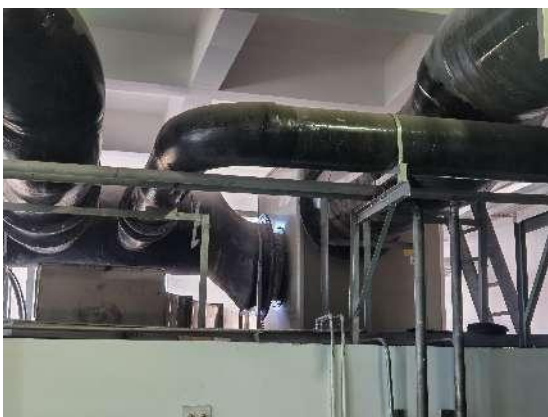
配套除臭系统（管道和风机）
