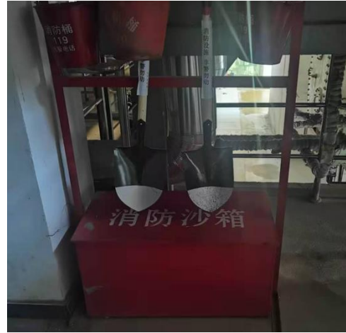
消防沙箱 铁锹 消防桶
