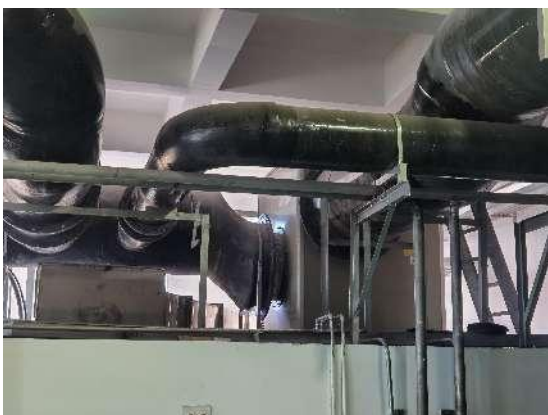
配套除臭系统（管道和风机）
