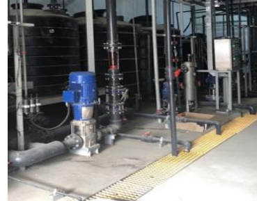
膜处理车间地面收集槽
